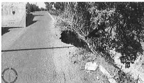
Vista del deslave que está ocurriendo en el margen izquierdo de la barranca, motivo del proyecto
