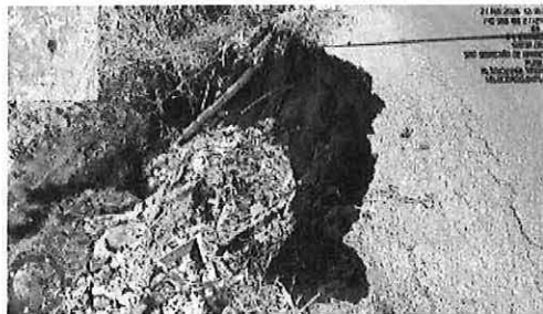
Se puede observar que la carpeta asfáltica de la calle Maximino Ávila Camacho ha sufrido daños, lo que es un riesgo para la población que transita en la zona
